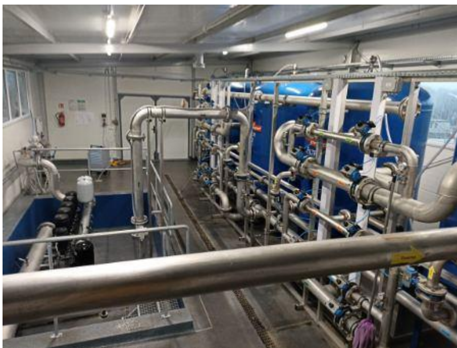
Fot. Zmodernizowana Stacja Uzdatniania Wody w Lipinkach Łużyckich
