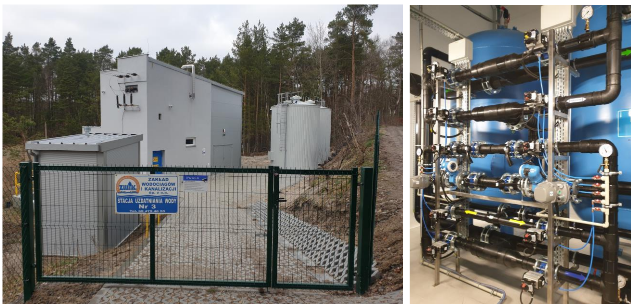
Fot. Zmodernizowana Stacja Uzdatniania Wody nr 3 w Żarach
